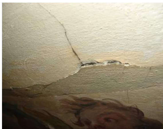
Fig. 6 Sollevamenti di intonaco prima dell'intervento
